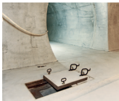
Tapa de registro abierta Tampa de registo aberta
